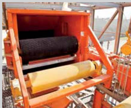
CINTA TRANSPORTADORA 1.500t/h (54")
