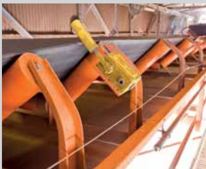
CINTA TRANSPORTADORA 1.500t/h (54")
