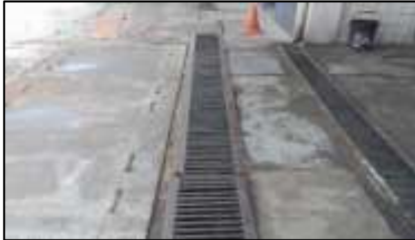
Vista fotográfica N° 16: Trampa de grasas.
