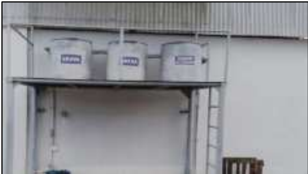
Vista fotográfica N° 17: Tratamiento de efluentes no domésticos.
